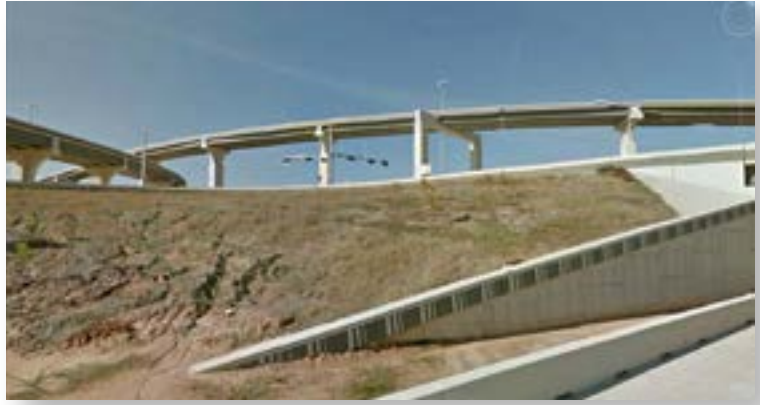
En el área del proyecto los daños por escorrentilla y la falta de vegetación fueron comunes.
